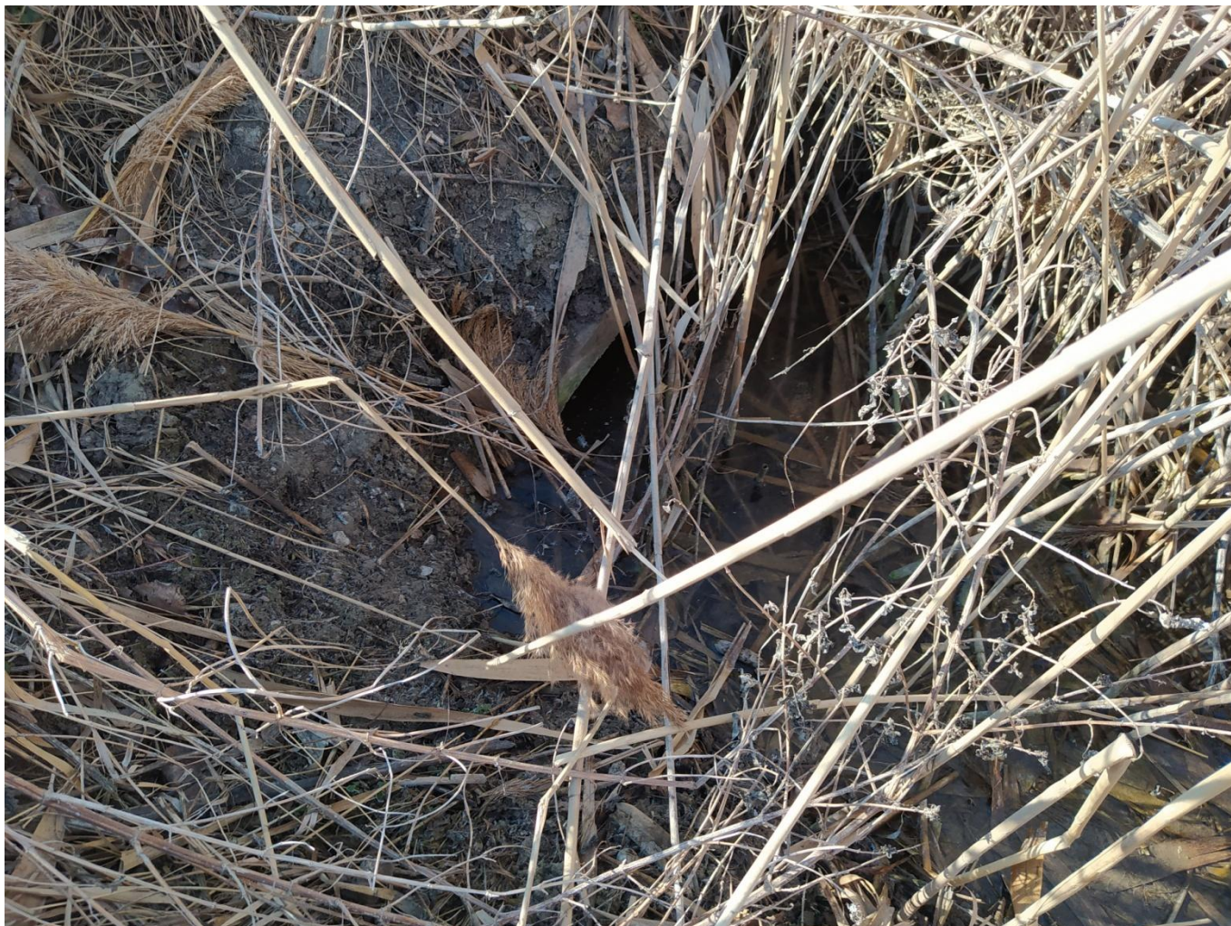
Obr. 3 Nefunkční propustek TP4 v km 0,474 k rekonstrukci
